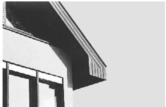
Falsch: zu massives Ortgesimse, bündig mit Dachfläche
